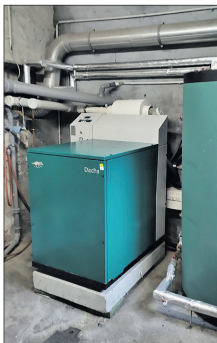
Blockheizkraftwerk im Haus von Hilde und Ulli. Foto: Ohmstedt/Brosziewski
